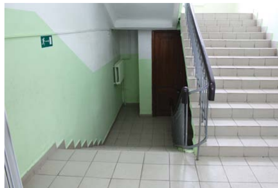
По такой лестнице инвалиды-колясочники совершенно точно не смогут попасть в здание
