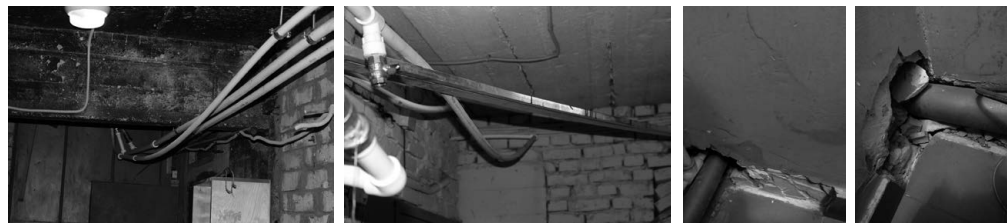
Инженерные сети в подвале дома №218 по улице Молодогвардейской в городе Самара. Отдельные трубы, не закреплены надлежащим образом и провисают, а в одном месте поддерживаются строительным правилом во избежание падения.
