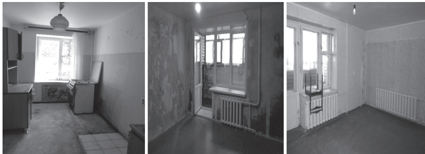
Состояние жилого помещения, предоставляемого семье заявителя, до проведения ремонта.
